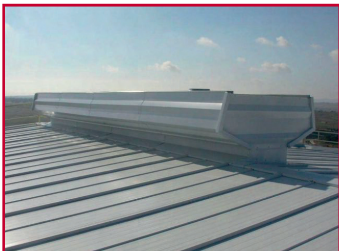
Ventiladores en Fábrica de Covap
